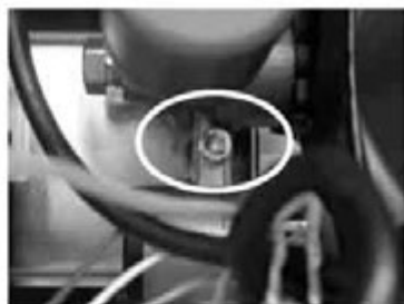
Bild 48: rechter Anschluss Plattenwärmetauscher
